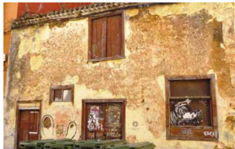
Casa sobradada abandonada en la calle Candilas.
